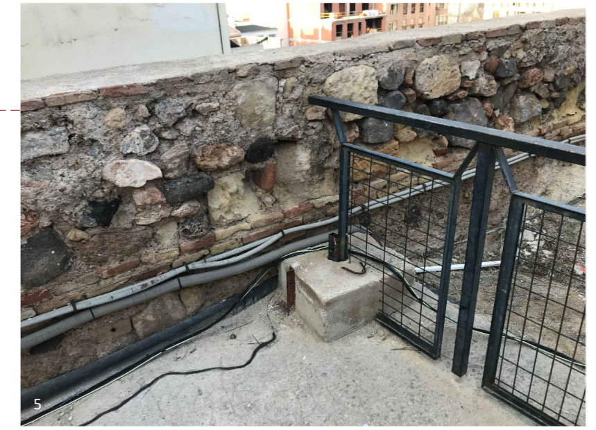
5 Cableado de acometida y distribución.
